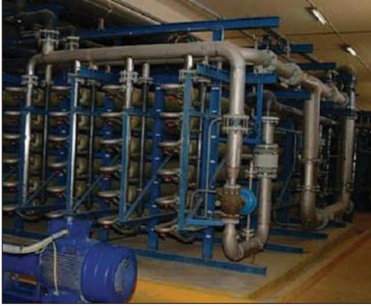
محطة تحلية المياه بقابس (منظر داخلي)
